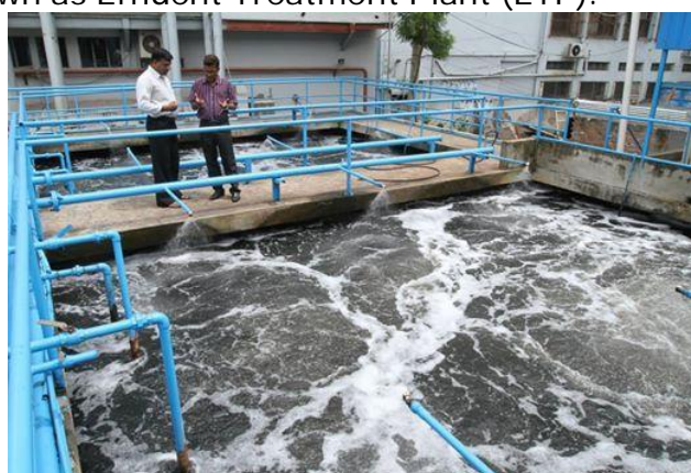
Fig: Effluent Treatment Plant
